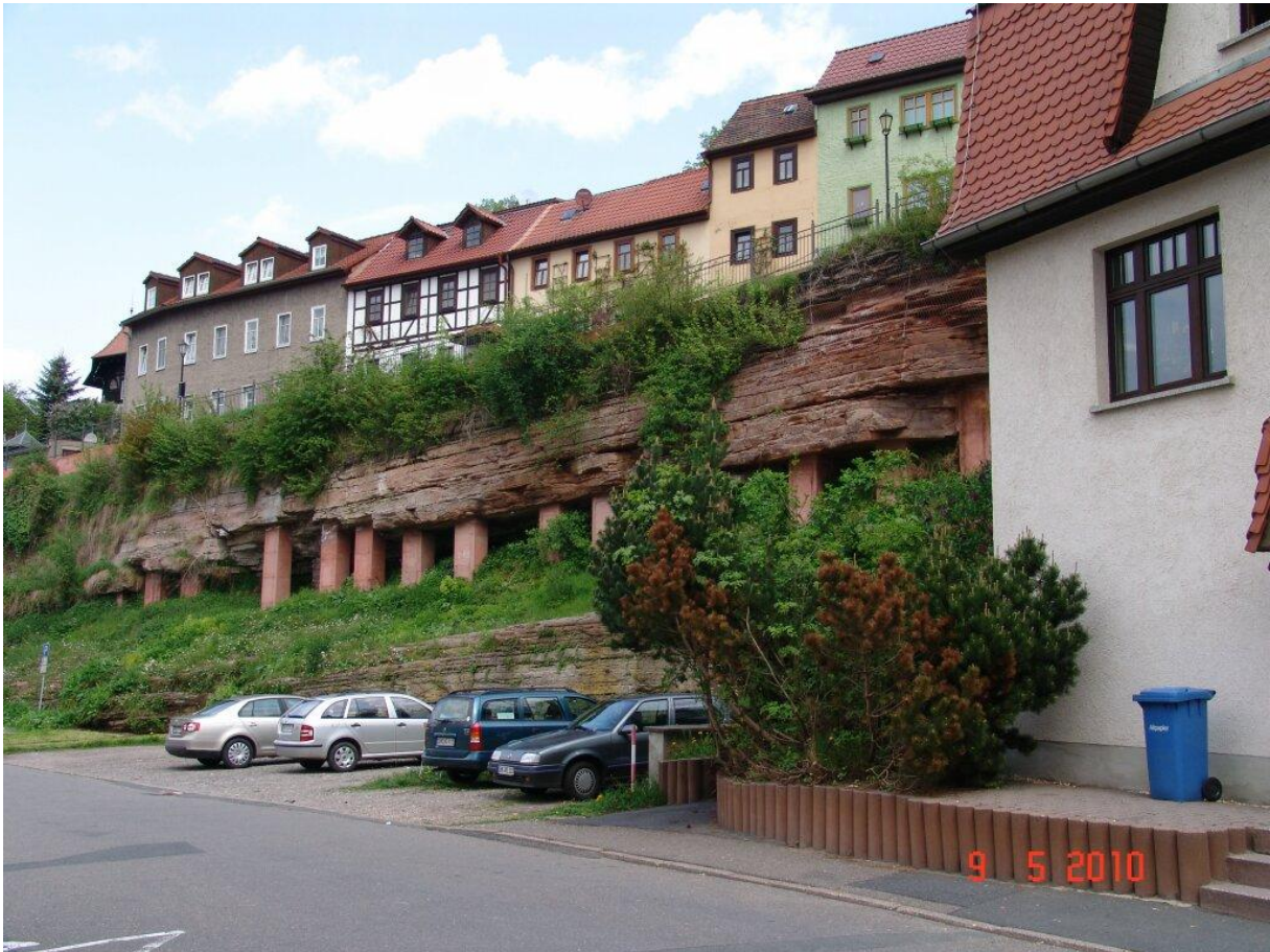
Hier hat man die auf Felsen stehende Häuserzeile abgestützt.
