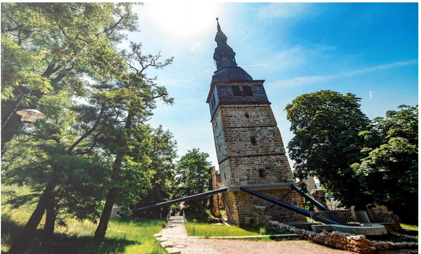
Heute wird er von zwei Seiten abgestützt und erhielt zwei Betonplatten unter dem Fundament. Hinter dem Turm die verfallenen Außenmauern des ehemaligen Kirchenschiffs (vgl. auch Foto oben). Für die Zukunft ist angedacht, das Schiff mit einem Dach zu versehen und den Turm begehbar zu gestalten.
